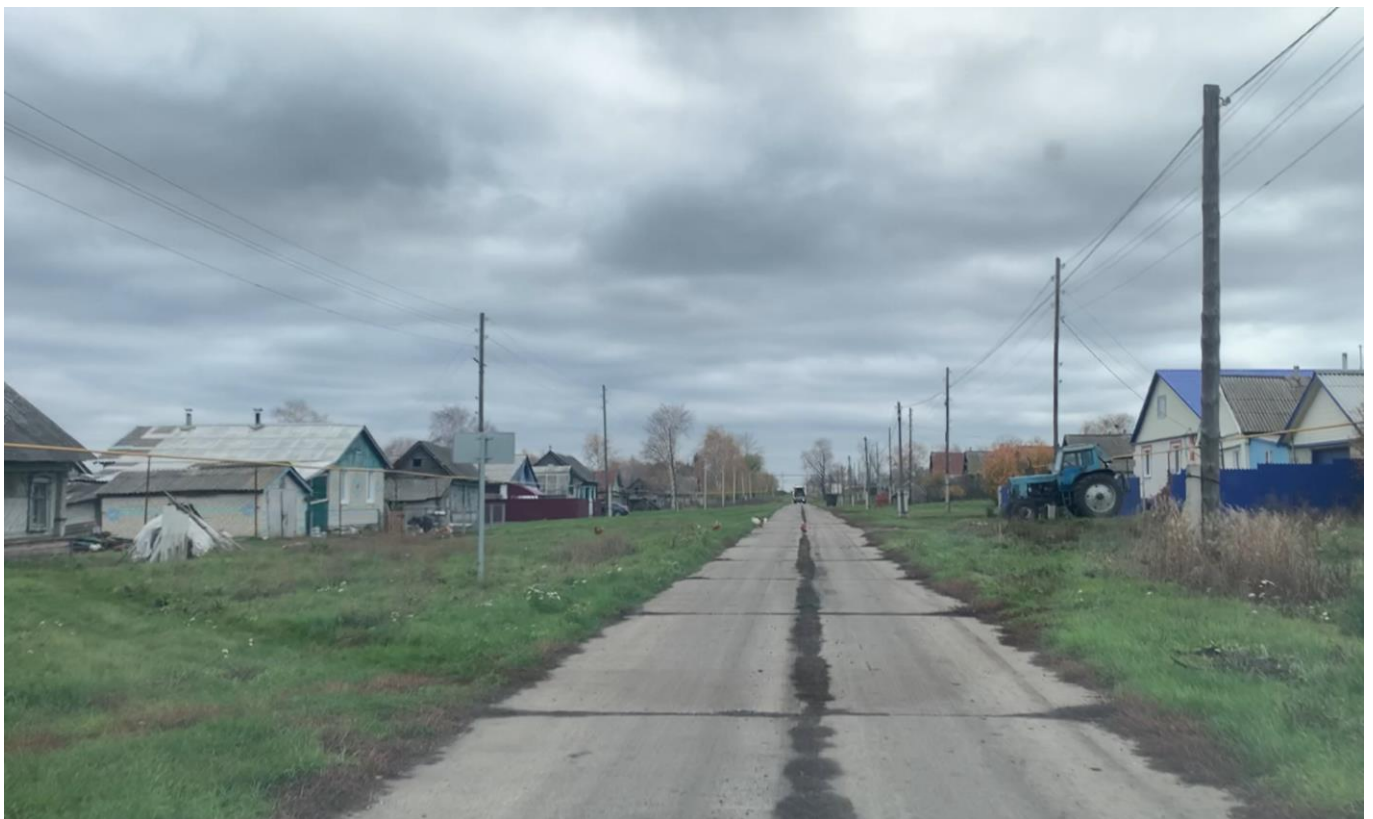
Рисунок 1.3.7 – Состояние покрытия автомобильной дороги в с. Селище, Ленинская улица
