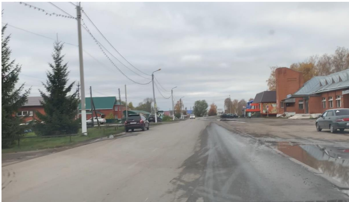
Рисунок 1.3.1 – Состояние асфальтобетонного покрытия в рп. Атышево, улица Центральная
