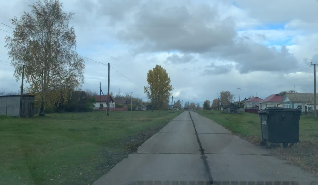
Рисунок 1.3.6 – Состояние покрытия автомобильной дороги в д. Чебудасы, улица Кочеткова
