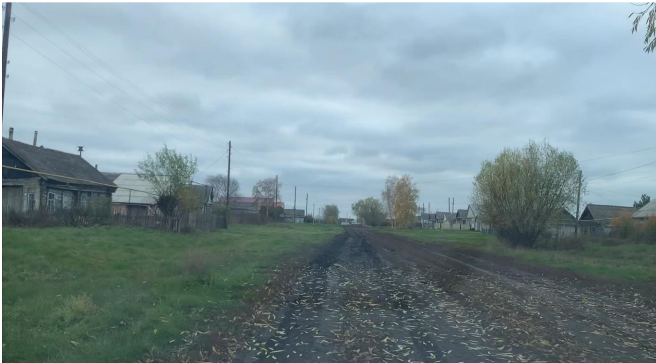
Рисунок 1.3.8 – Состояние покрытия автомобильной дороги в с. Алашеевка, улица Чапаева
