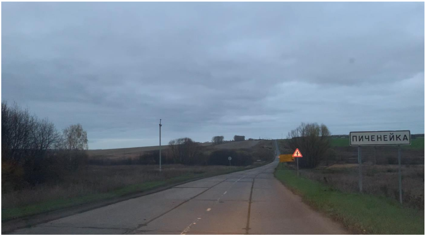
Рисунок 1.3.18 – Состояние покрытия автомобильной дороги в д. Пичинейка
