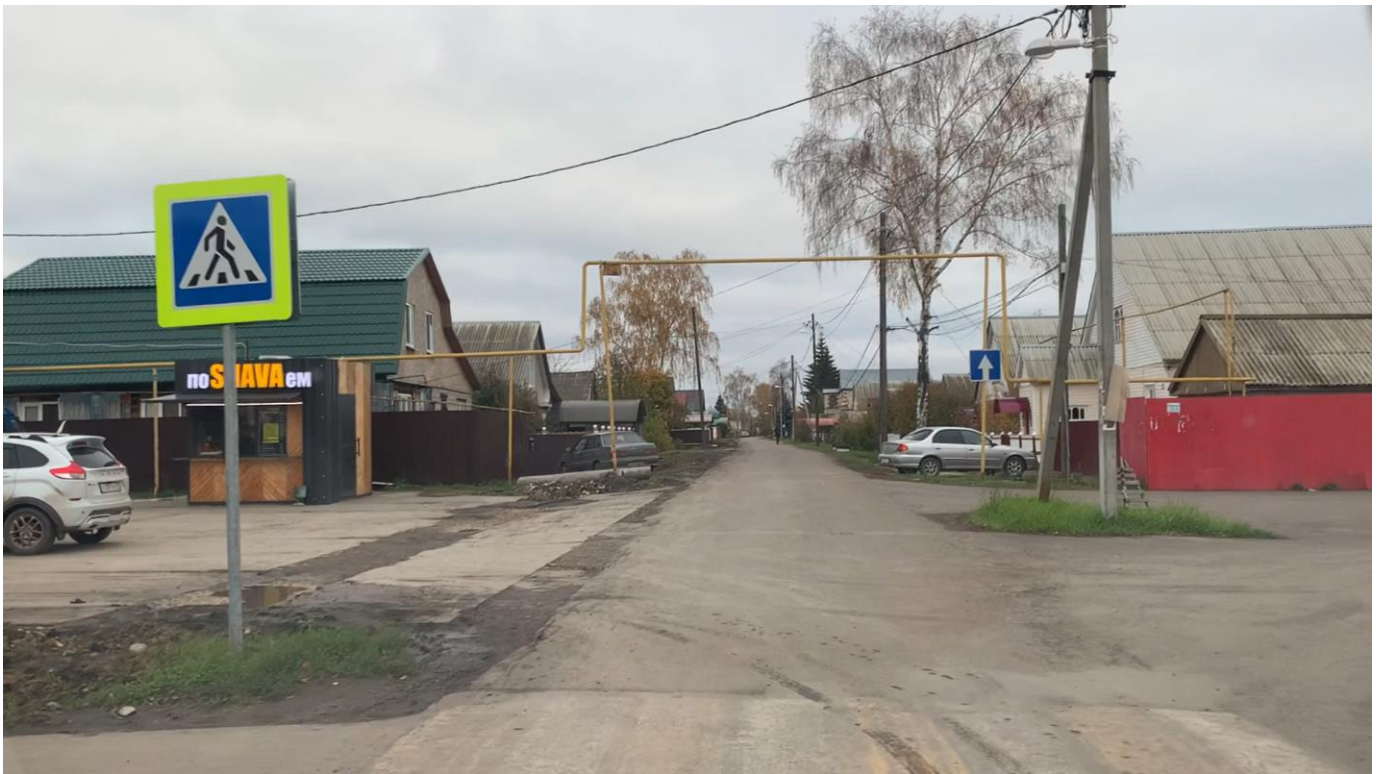
Рисунок 1.3.3 – Состояние покрытия автомобильной дороги в рп. Атышево, Первомайская улица
