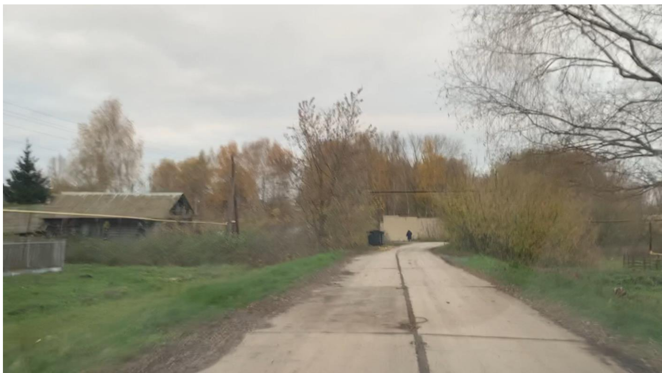
Рисунок 1.3.15 – Состояние покрытия автомобильной дороги в с. Капасово, Центральная улица
