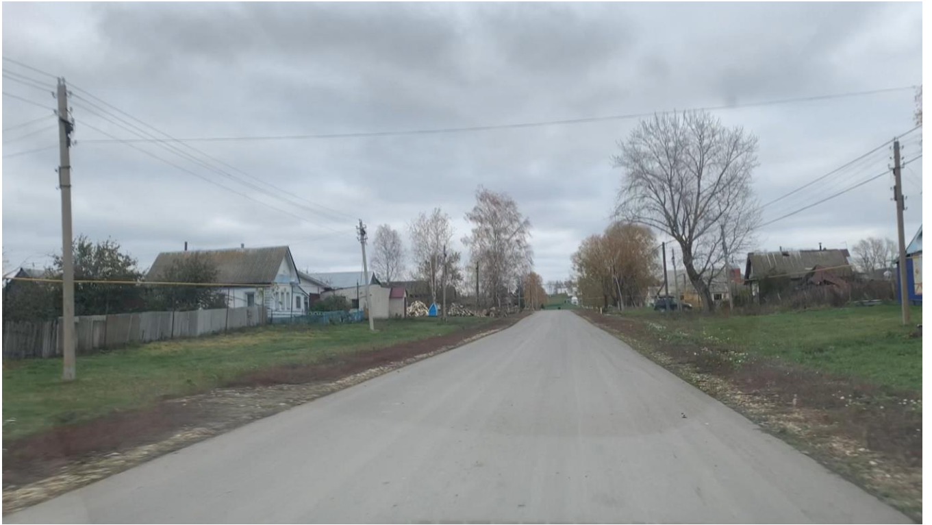
Рисунок 1.3.10 – Состояние покрытия автомобильной дороги в с. Сабанчеево, Советская улица
