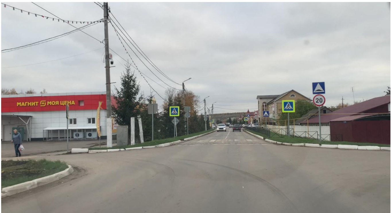
Рисунок 1.3.4 – Состояние покрытия автомобильной дороги в рп. Атяшево, Школьный переулок
