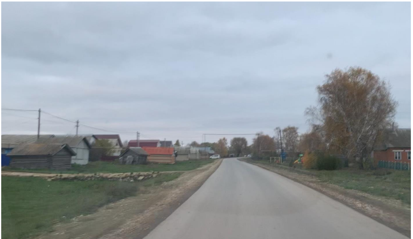
Рисунок 1.3.16 – Состояние покрытия автомобильной дороги в с. Батушево, улица Ленина
