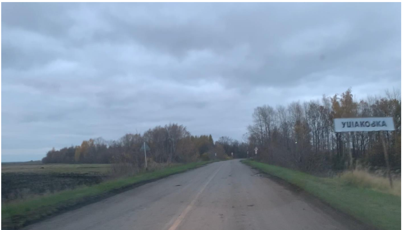
Рисунок 1.3.17 – Состояние покрытия автомобильной дороги в с. Ушакова
