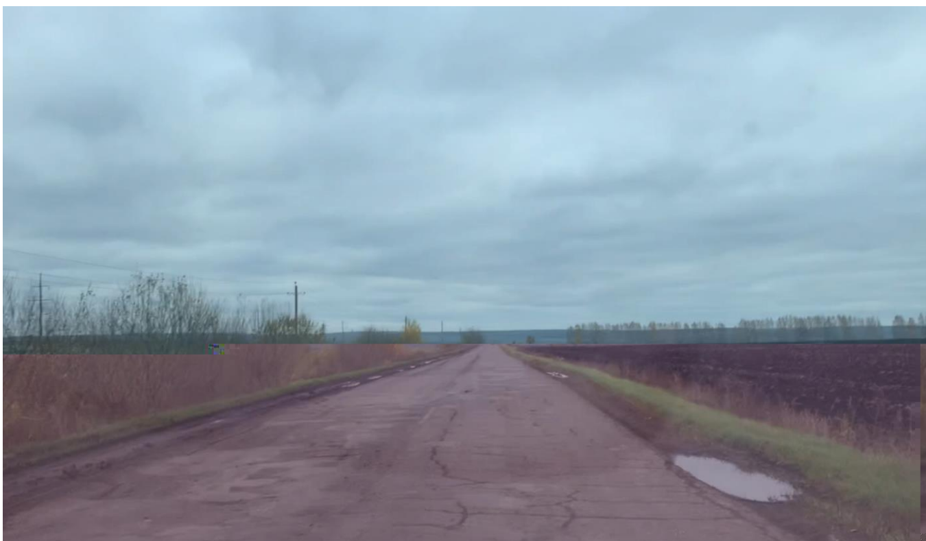
Рисунок 1.3.9 – Состояние покрытия автомобильной дороги в с. Алово
