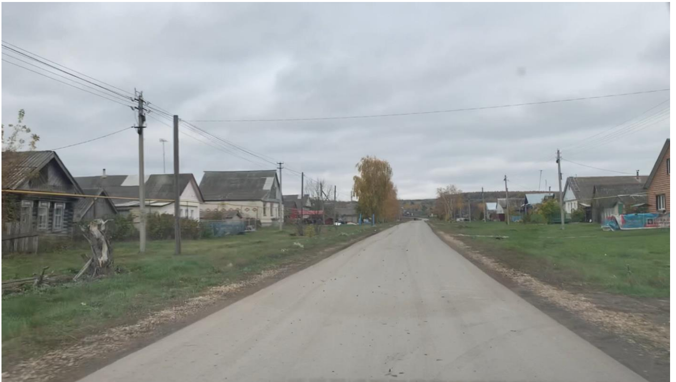
Рисунок 1.3.11 – Состояние покрытия автомобильной дороги в д. Мордовские Дубровки, Октябрьская улица
