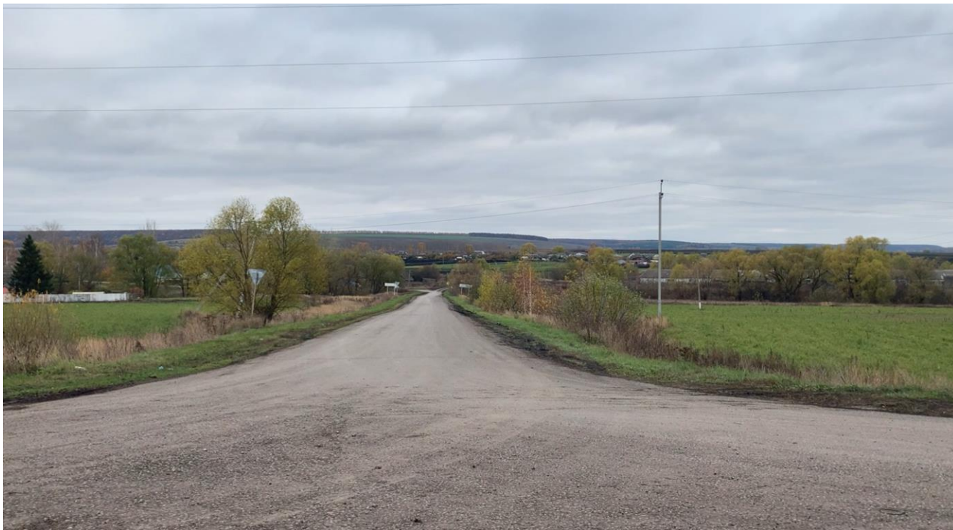
Рисунок 1.3.12 – Состояние покрытия автомобильной дороги в с. Тарасово
