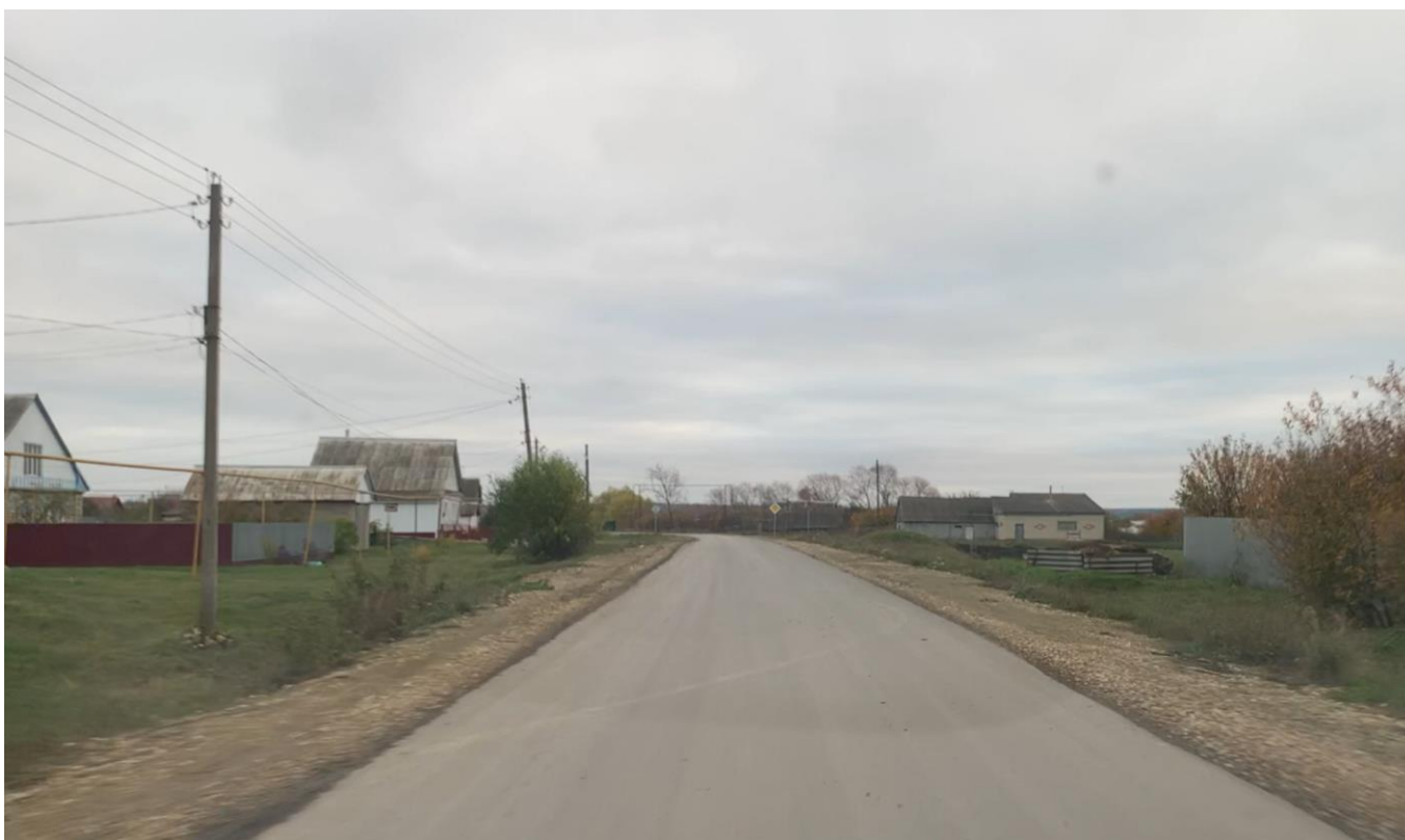
Рисунок 1.3.13 – Состояние покрытия автомобильной дороги в с. Атяшево, Набережная улица
